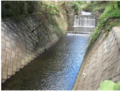
▲三面張りされ大きな段差のある河川
